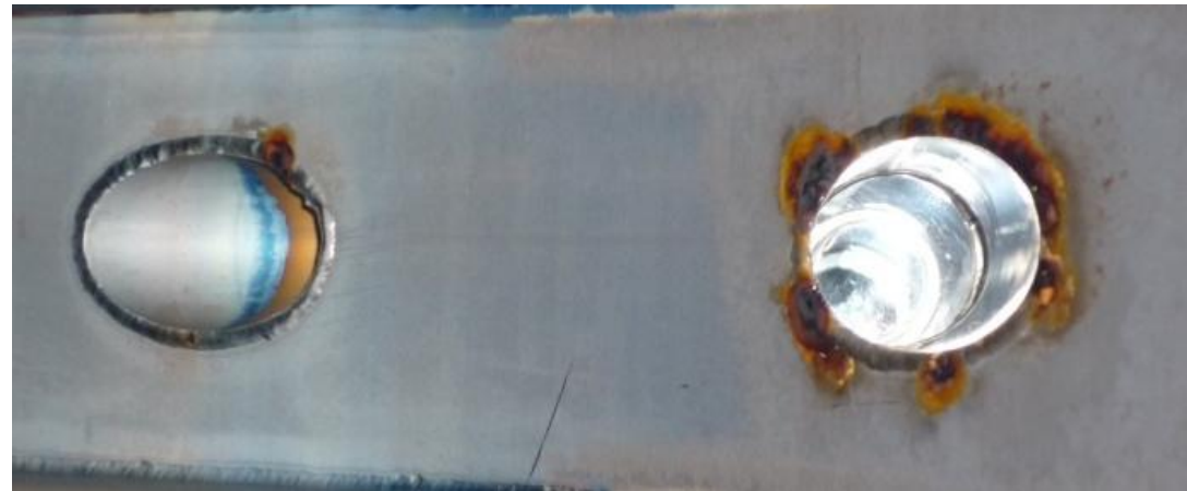
Corrosion de la chambre inox coté vide
